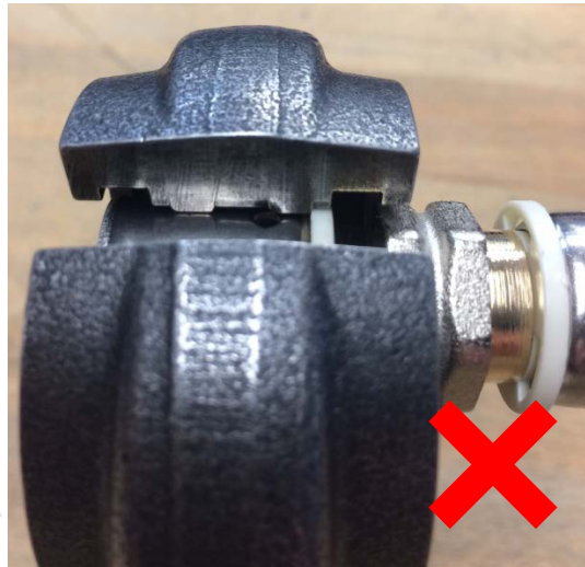
Nesprávne usadenie čel'uste na lisovacom fittingu
