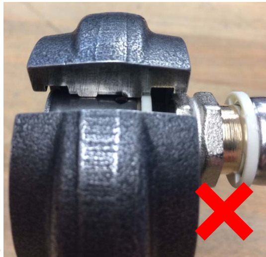
Nesprávne usadenie čel'uste na lisovacom fittingu
